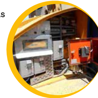
NO USAR LOS REPUESTOS ADECUADOS
