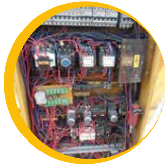
NO REALIZAR MANTENIMIENTO PREVENTIVO Y CORRECTIVO ADECUADOS
