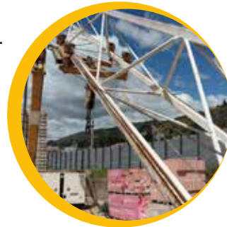
INTERVENCIÓN DE EQUIPOS POR PARTE DE PERSONAL NO ESPECIALIZADO
